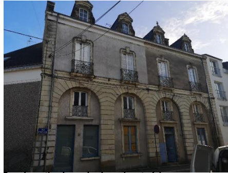
Transformation du rez-de-chaussée autrefois commerçant avec une modification de percement et un traitement de façade inadapté à la qualité de l'ensemble du bâtiment.
