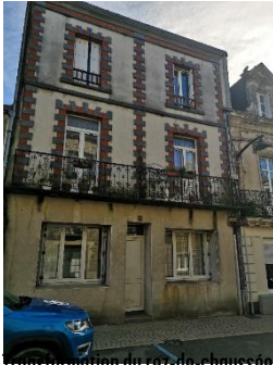
Transformation du rez-de-chaussée en commerce et appauvrissement du traitement décoratif
